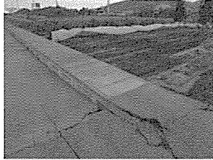
㉔道路の沈下（20cm）
