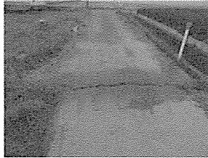
㉕道路の開口亀裂と噴砂
