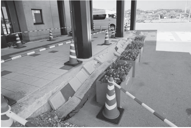
建物と駐車場の境目にできた段差
