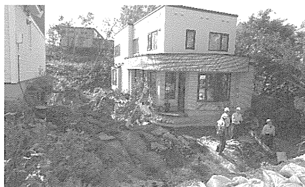
(b) 道路部擁壁からの住宅の沈下
