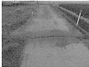
㉕道路の開口亀裂と噴砂
