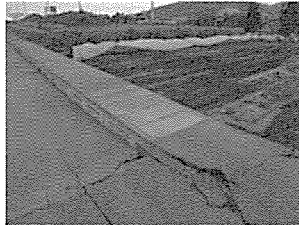
㉔道路の沈下（20cm）
